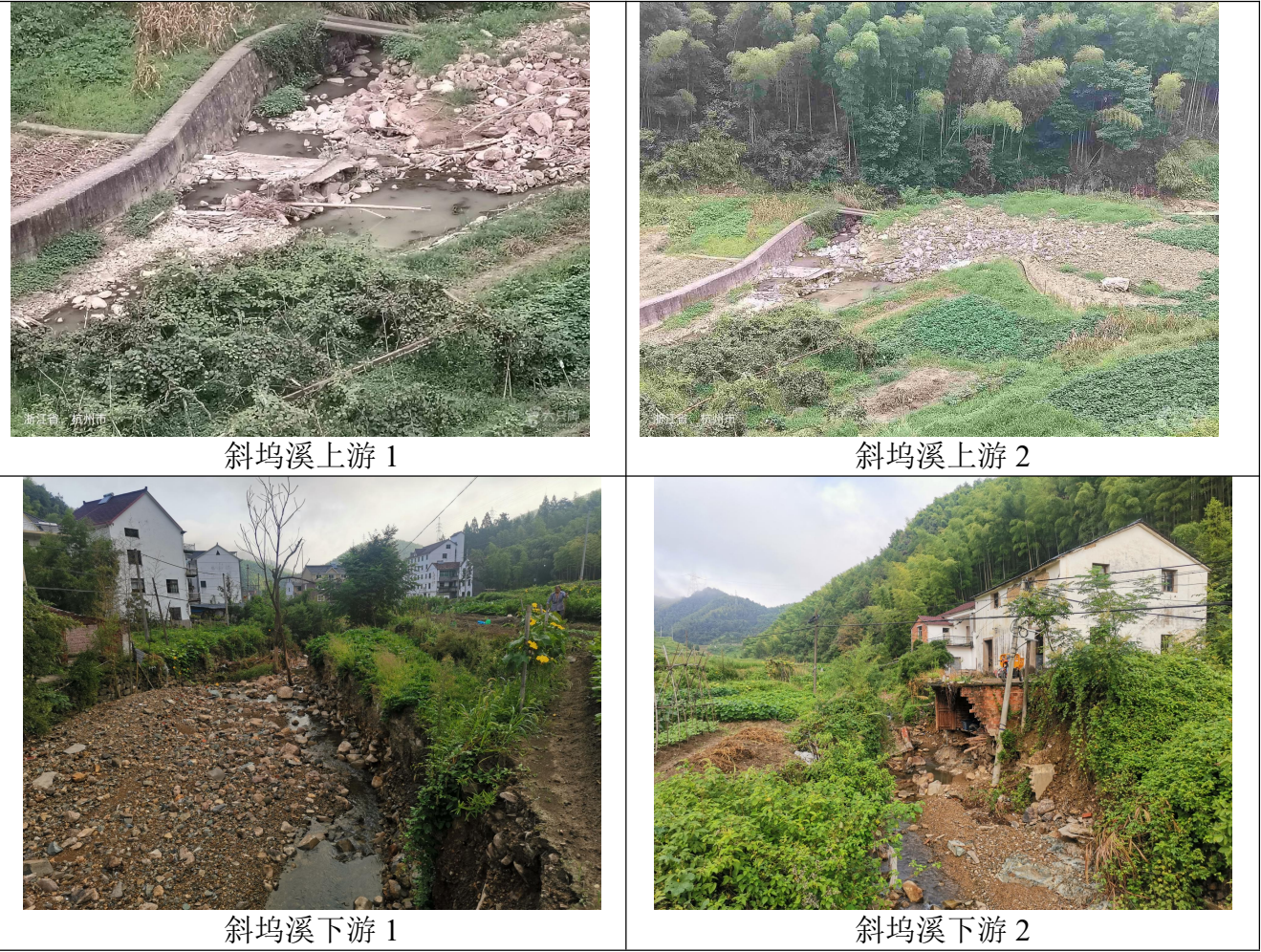
图 3.1 排洪沟冲毁现状
