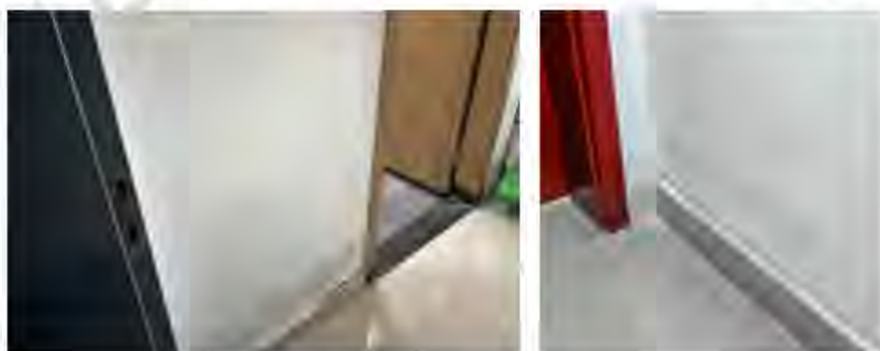
图 31 卫生间外侧墙根渗漏返潮
