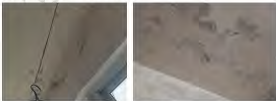
图 38 顶棚霉斑脱落
