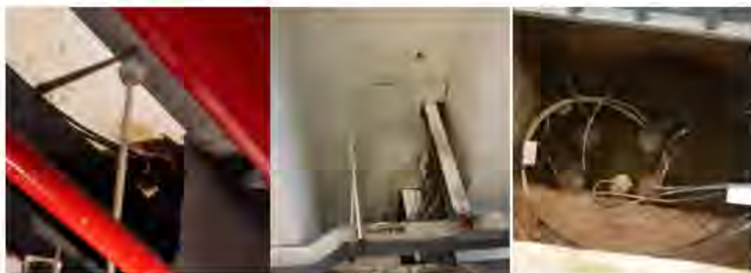
图 23 穿管位置渗漏现场图
