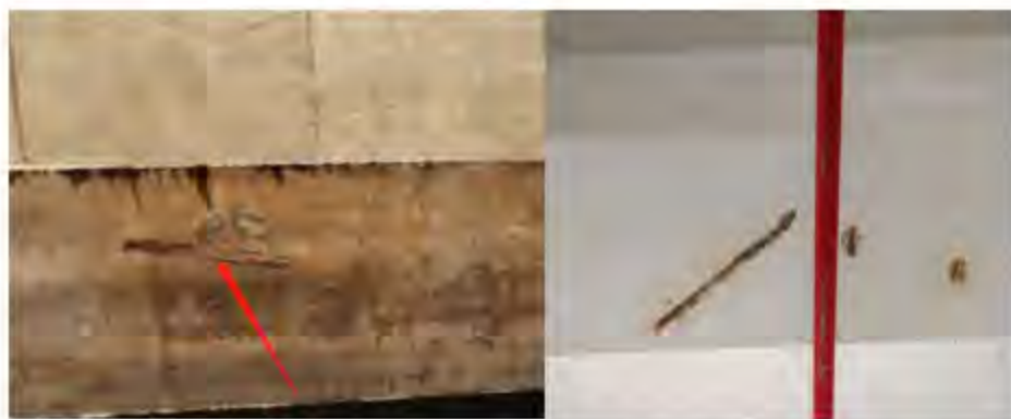
图 82 混凝土结构钢筋锈蚀膨胀
