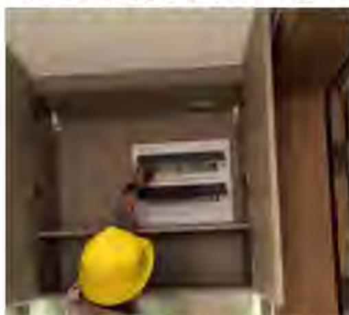
图 86 户内配电箱设置于柜子内
