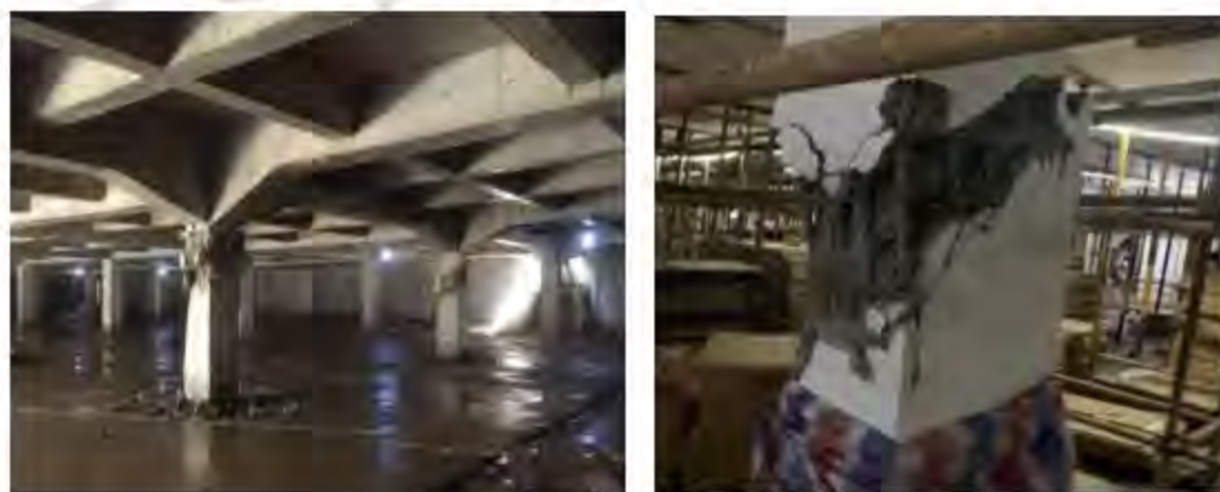
图 2 地下室柱发生剪切破坏
