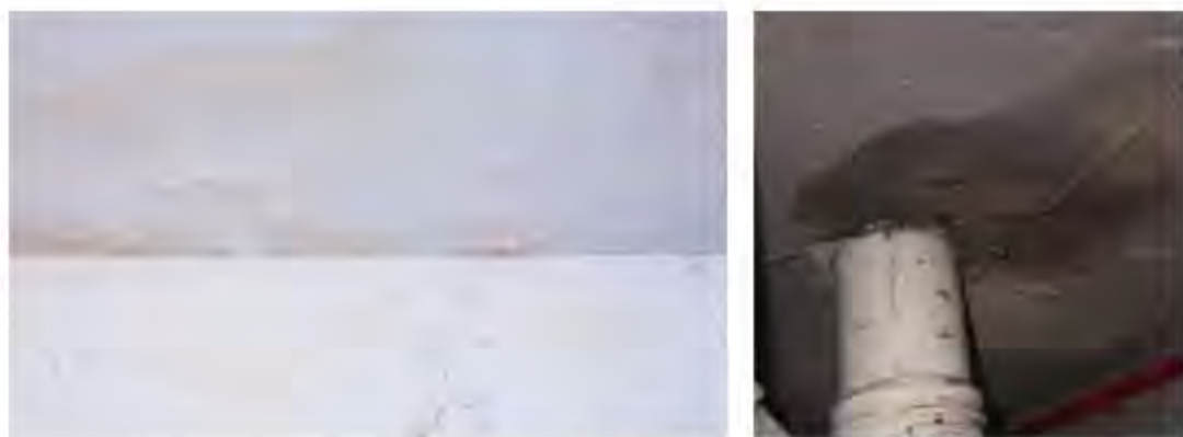
图 39 顶棚涂料起皮渗漏
