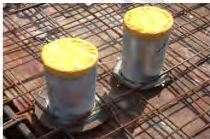
图 45 传统铁丝固定造成渗漏
