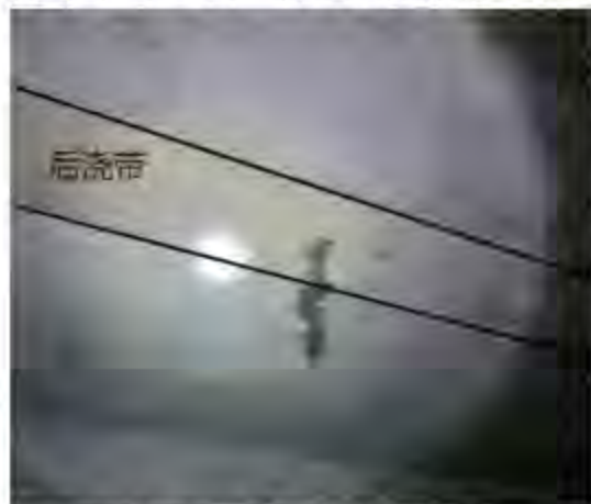
图 28 地下室顶板渗漏
