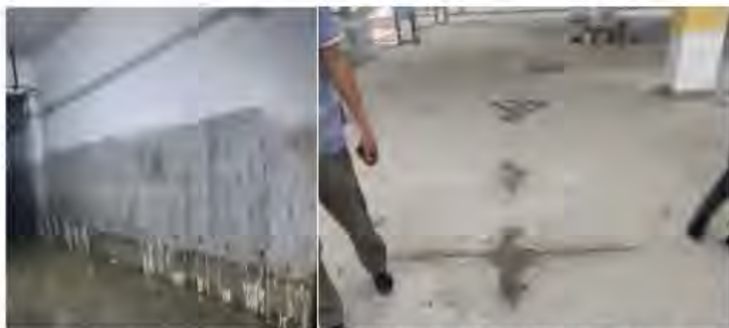
图 12 地下室侧墙、地板渗漏现场图
