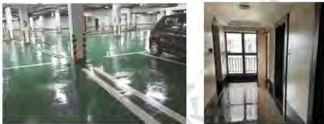
图 73 地下车库区、入户门厅返潮
