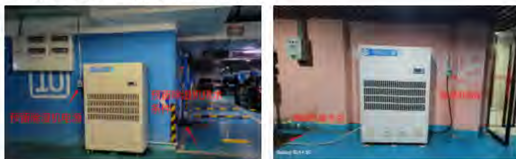
图 74 地下车库车道旁、入户门厅旁安装除湿机
