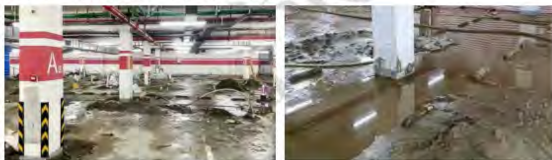
图 1 地下室底板开裂渗漏
