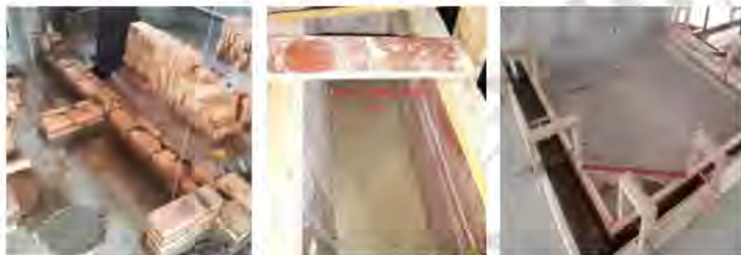
图 32 未设置混凝土反坎、反坎未凿毛、使用木撑条
